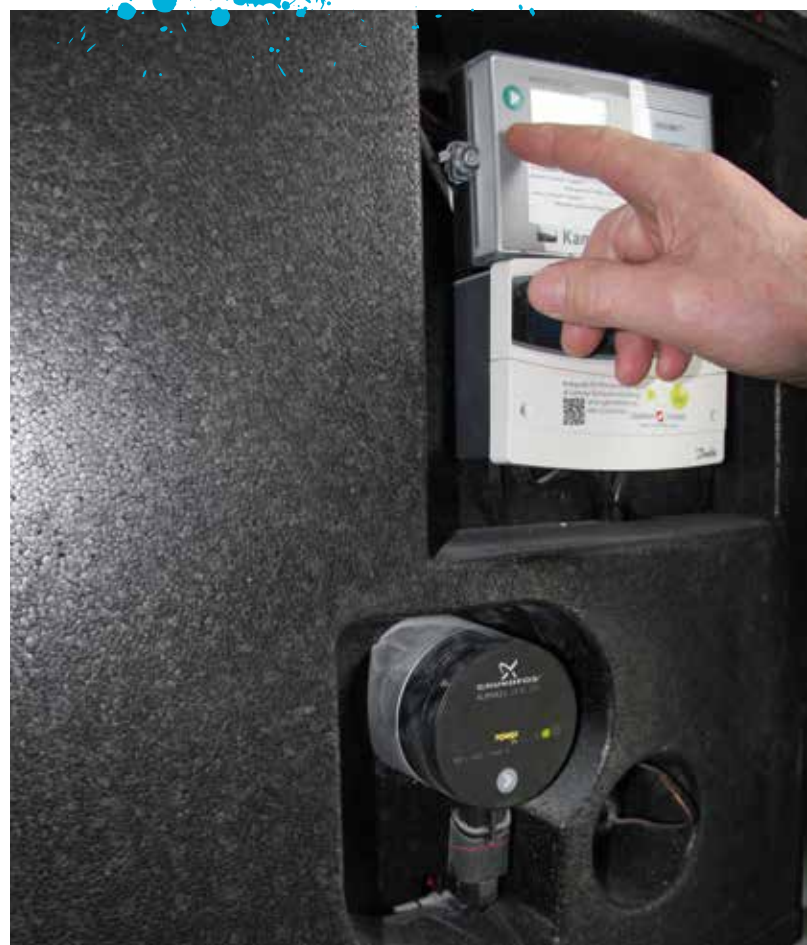
På fjernvarmemåleren kan Povl Jørgensen løbende følge MWh-forbrug og returtemperatur.
